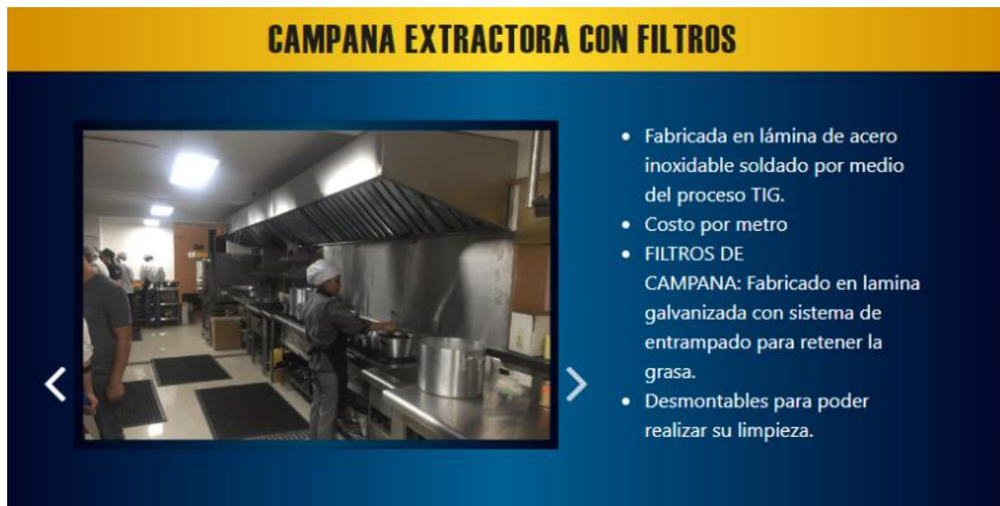
Ilustración 43. Campana extractora con filtros
