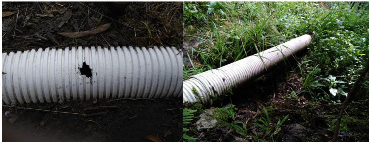
Figura 43: a. Tubería rota.
