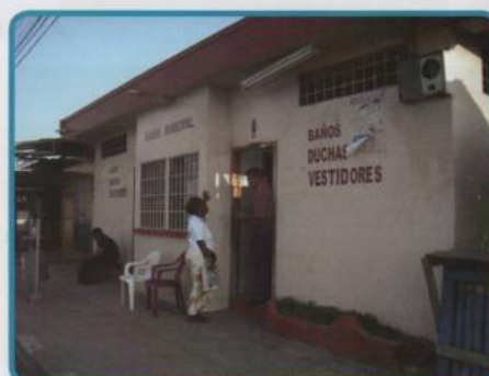
No hay acceso para las personas con discapacidad a los baños públicos, debido a la estrechez de la puerta de ingreso.
