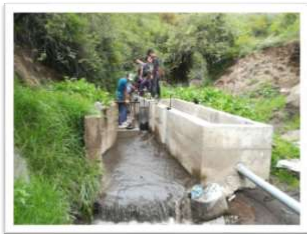
Figura 67. Tanque de captación – Quebrada el Tingo.
