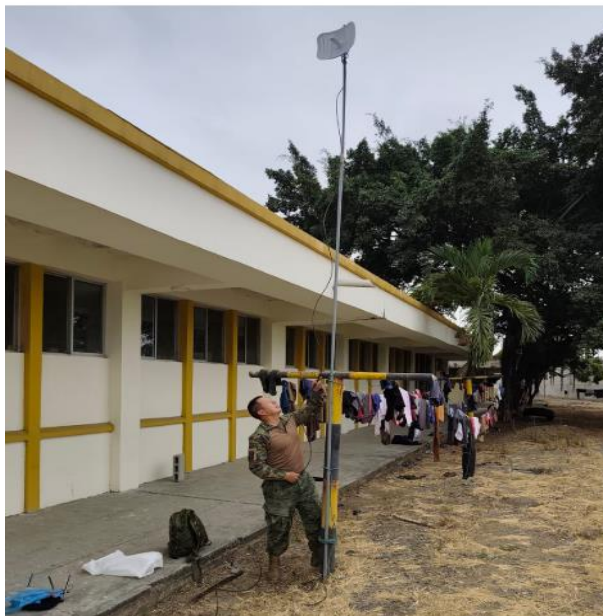
Figura 29. Instalación de la Segunda Antena Ubiquiti RECEPTOR (RX).
