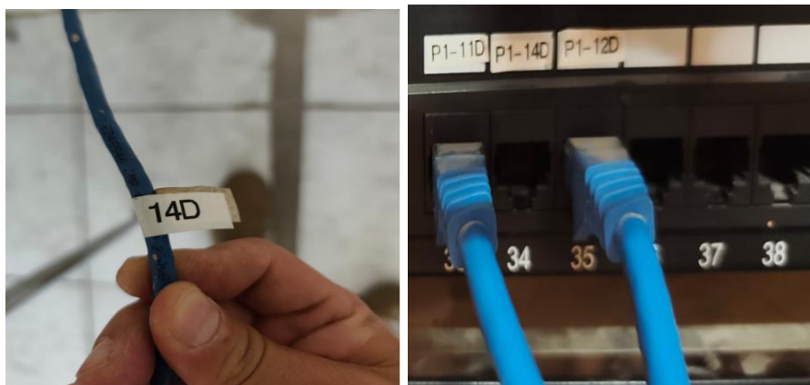
Figura 27. Etiquetado de cable de red UTP Cat 6a.
