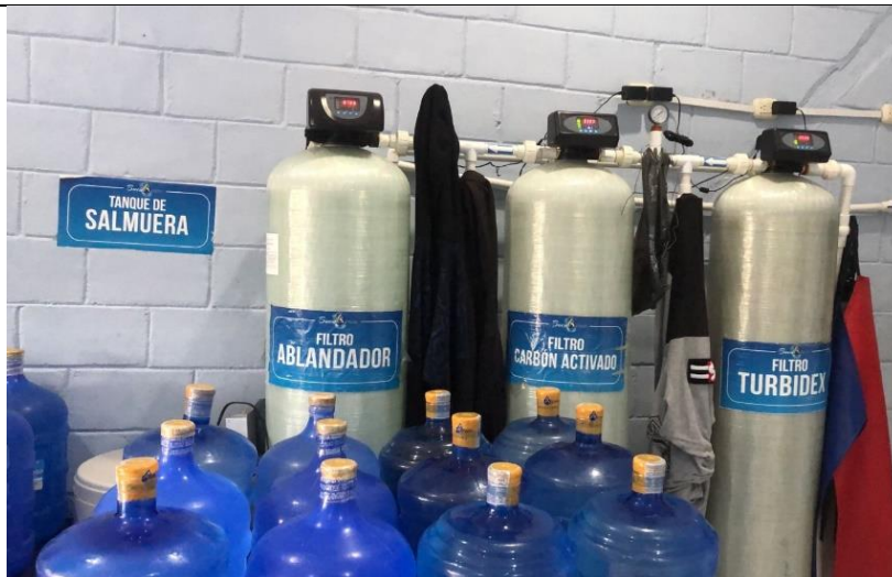
Figura 35 Área de filtrado del líquido
