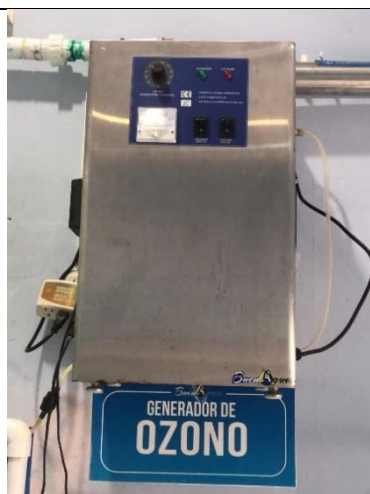
Figura 36 Generador de ozono
